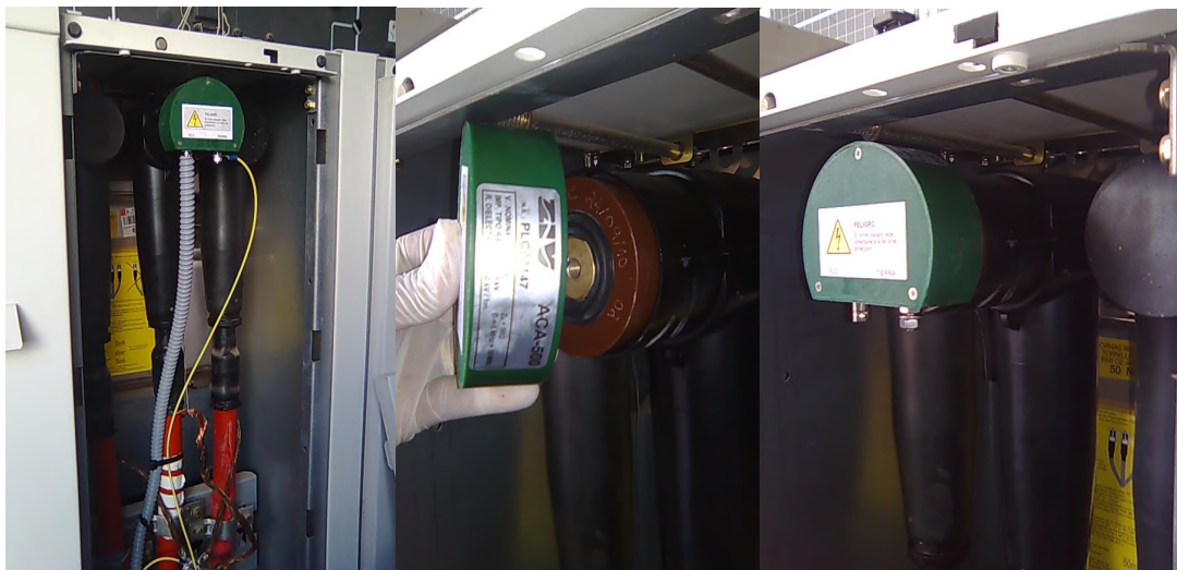
Figura 18 - Acoplos PLC Capacitivos
